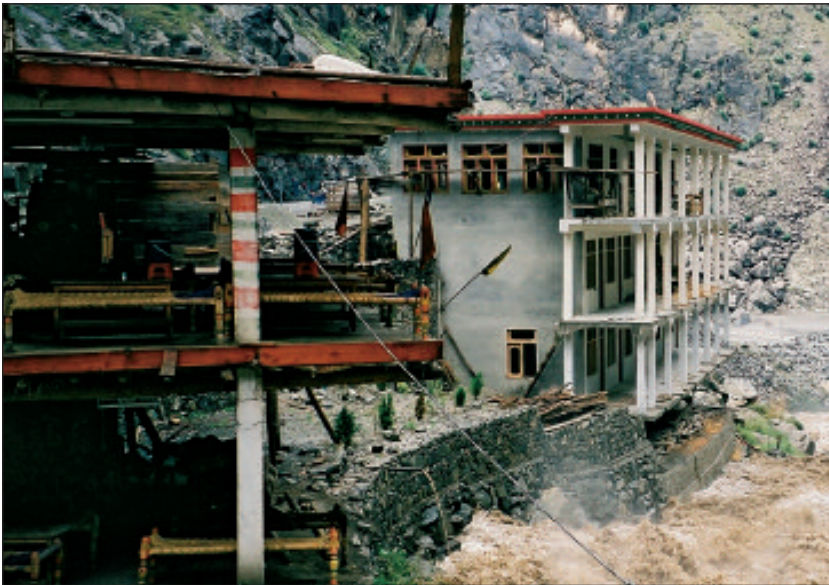
Figur 10: Nytt hotellbygg i Indusdalen – dårlig sikret mot rystelser, ras og flom? (Foto: Ø. Larsen)
